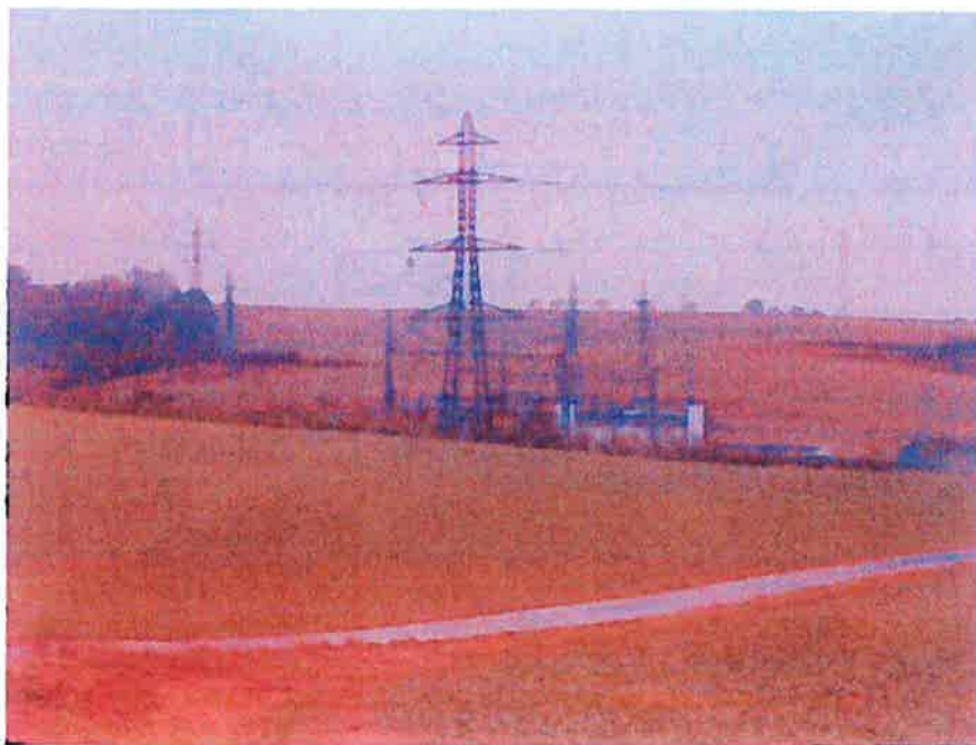
Structure actuelle du poste de Seuil
