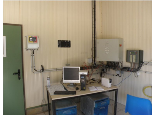
Un système informatique performant gère la surveillance des bâtiments
