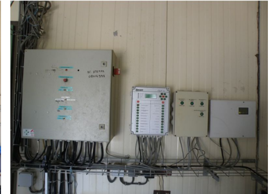
Les armoires électriques
