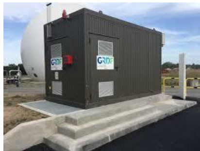
Figure 33 : Poste d'injection de Biométhane GRDF.
