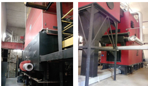
Chaudières du réseau de chaleur urbain de Sedan (source : Dalkia)
