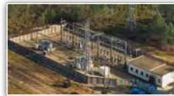
Installation de production d'électricité ou de biométhane
