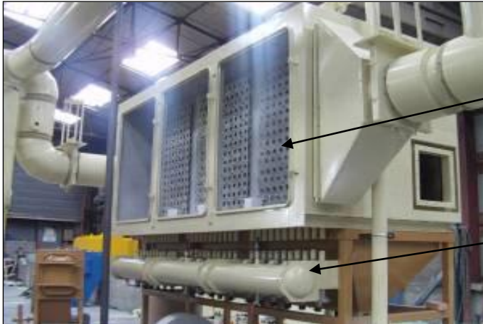
Tiroirs avec les éléments filtrants
