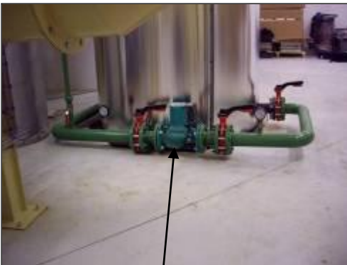
Pompe de circulation
