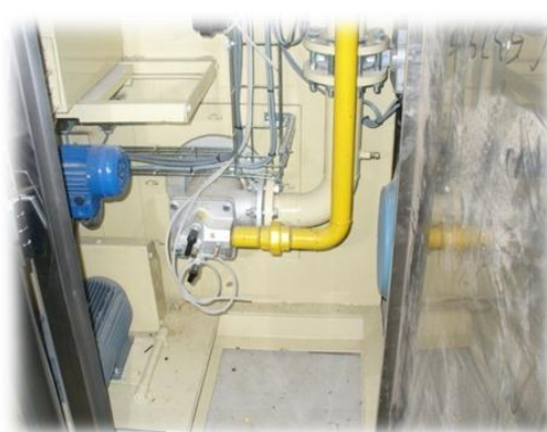
Brûleur de la chambre de postcombustion
