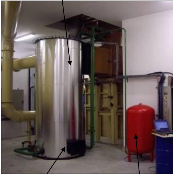
Trappe de ramonage calorifugée
