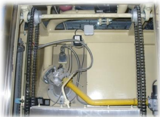
Brûleur de la chambre principale
