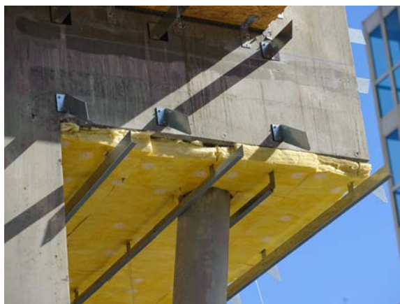
Pose d'isolant, qui constitue l'un des bouquets de travaux utilisés dans la rénovation énergétique des bâtiments
