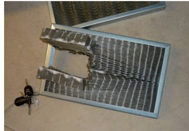
Filtre détruit par sur-encrassement
