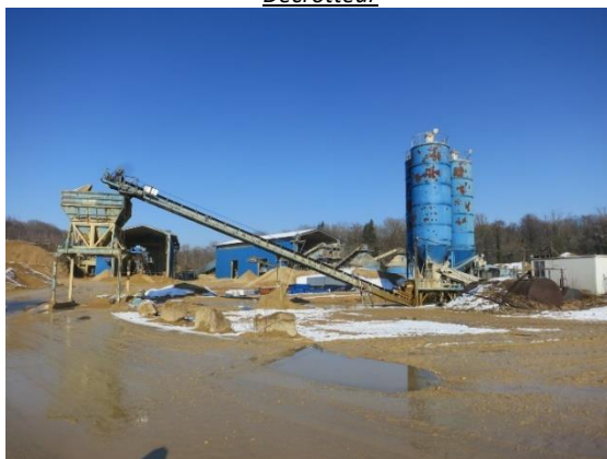
Centrale de malaxage
